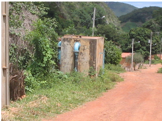
Caixa de quebra-pressão
