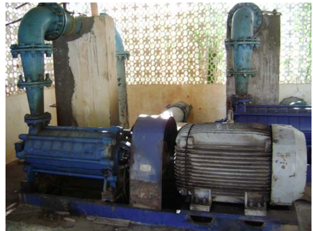
Elevatória AB – vista interna
