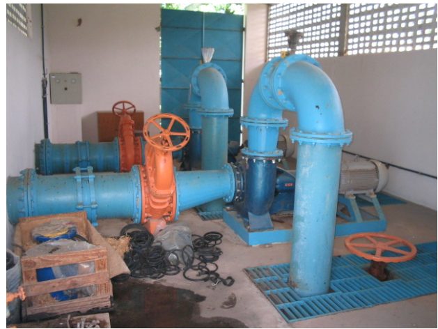
Elevatória de Água de Lavagem
