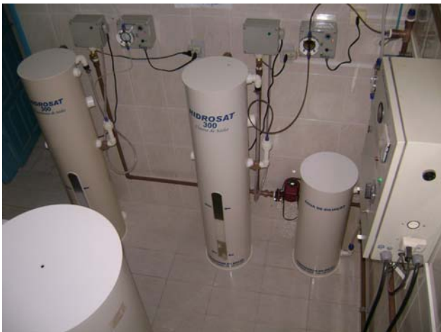
Sistema de geração e dosagem de hipoclorito de sódio
