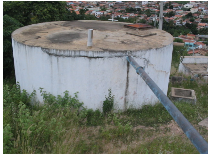
Reservatório de Contato 100 m 3
