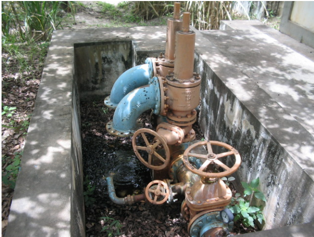
Elevatória AB – válvulas de alívio de pressão
