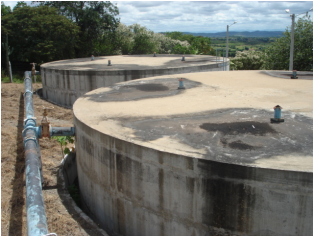
Reservatórios de Contato e de Distribuição 500 m 3
