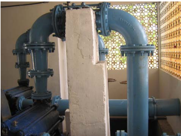
Elevatória AB – vista interna
