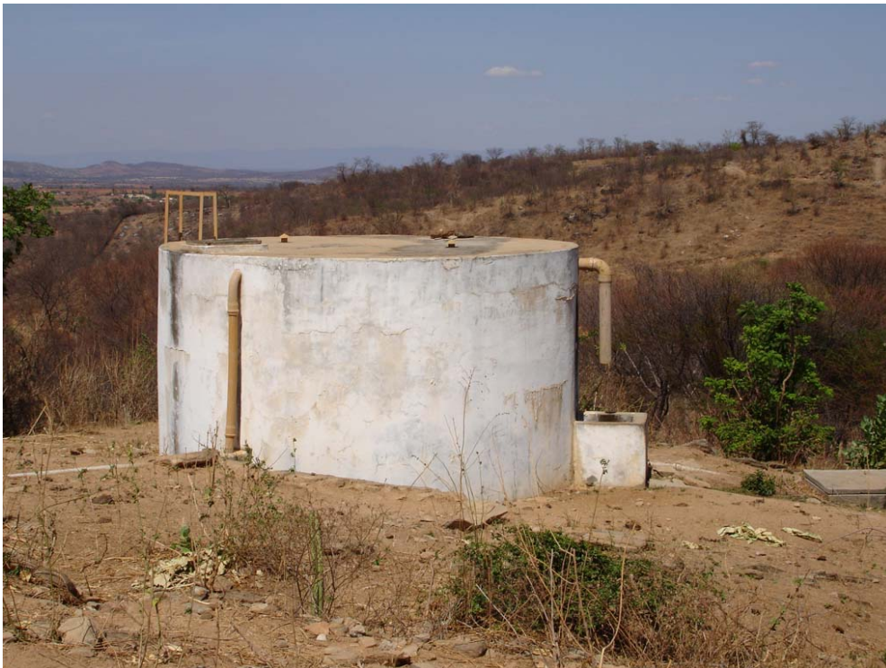
Reservatório de Distribuição 50 m 3 – atendimento localidades da zona rural
