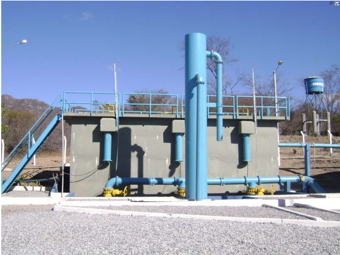
Clarificadores de Contato
