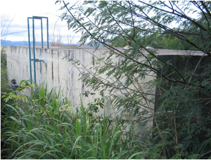
Reservatório de Distribuição 200 m 3
